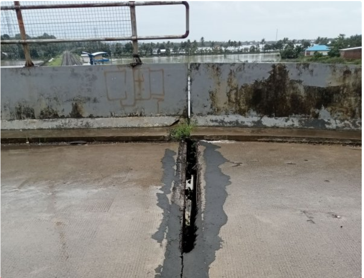
Sambungan jalan fly over Pekkae rusak parah
